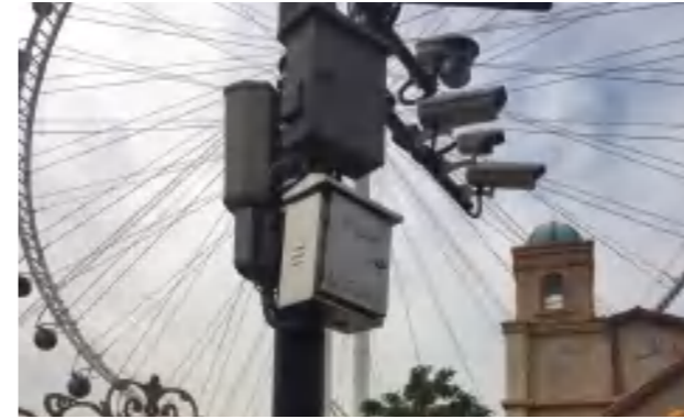
大良派出所华侨城欢乐海岸高清视频监控系统建设项目
